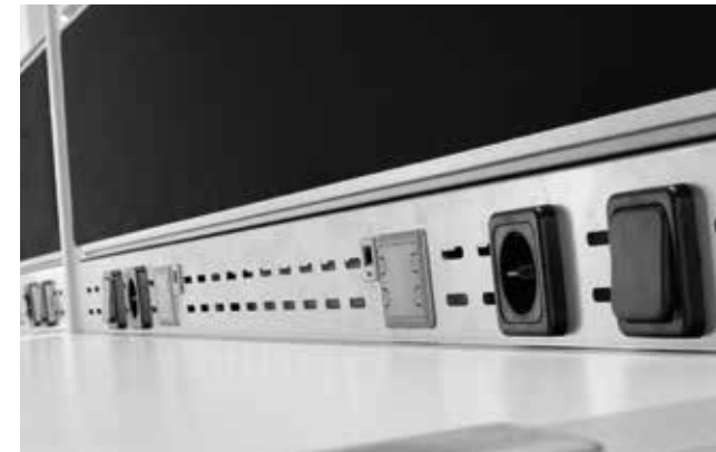
Prese dati ed energia su canalina frontale. Data and power sockets on the frontal channel. Données et prises de courant sur le canal frontal.
